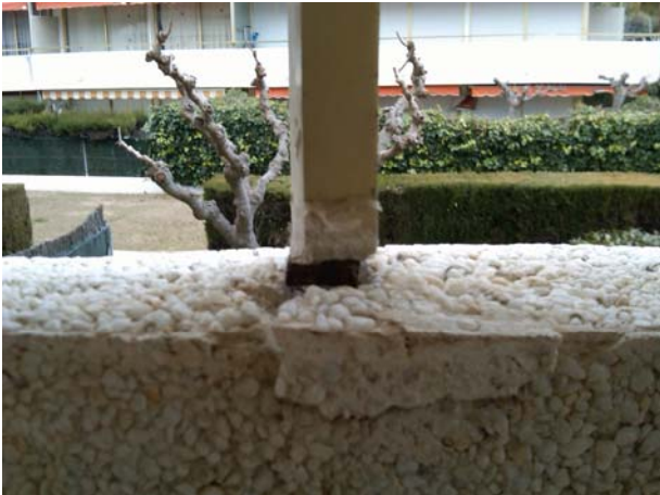
Foto IMG00311 Lesión Leve
