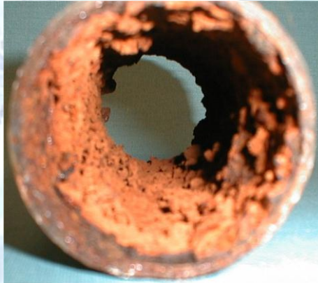
Fig. 1 – Ejemplo de proceso de corrosión en un circuito cerrado
